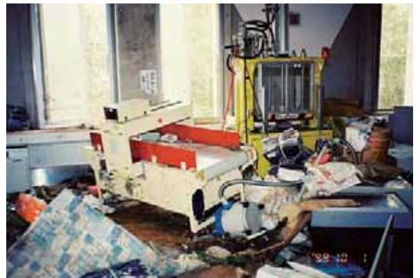
浸水で施設内の機械設備も損壊した
