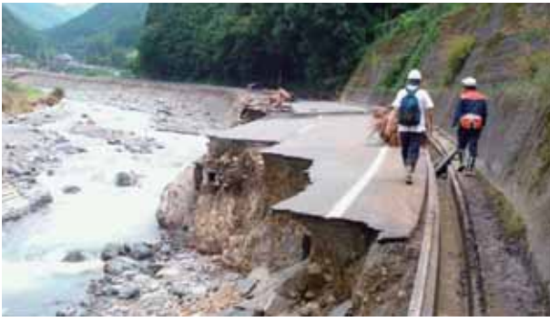
福知地区に通じる道路は完全に寸断され、孤立集落となる（奥福知地区に通じる主要道路はこの路線のみ）。そのため、宍粟市社協職員が徒歩により、被災地域のニーズの聞き取りを行った
